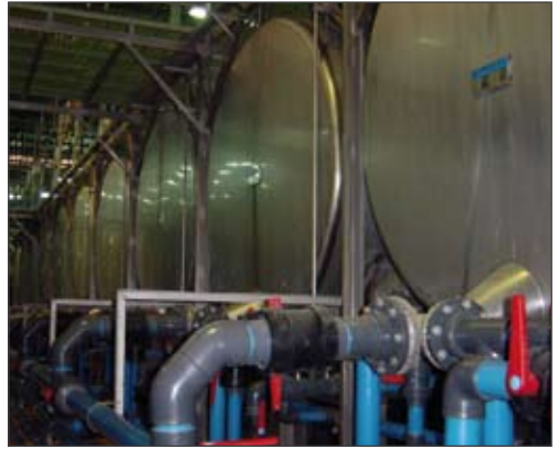
FOTO: Tanques de oxidación (M. A. Serrano)
